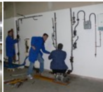
D'anciennes conduites montantes ... newes!
